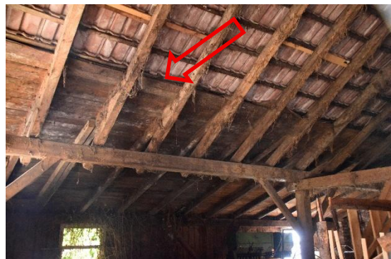
Abbildung 20: Haus Nr. 7, potentielle Fledermaus-Quartierstrukturen im Dach (zw. Dachziegel und Verkleidung, roter Pfeil)
