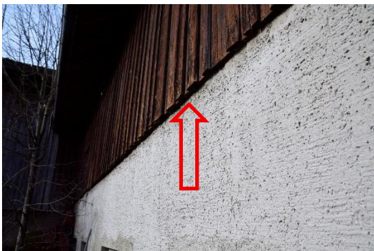
Abbildung 19: Haus Nr. 7, potentielle Fledermaus-Quartierstrukturen an der Hauswand (roter Pfeil)
